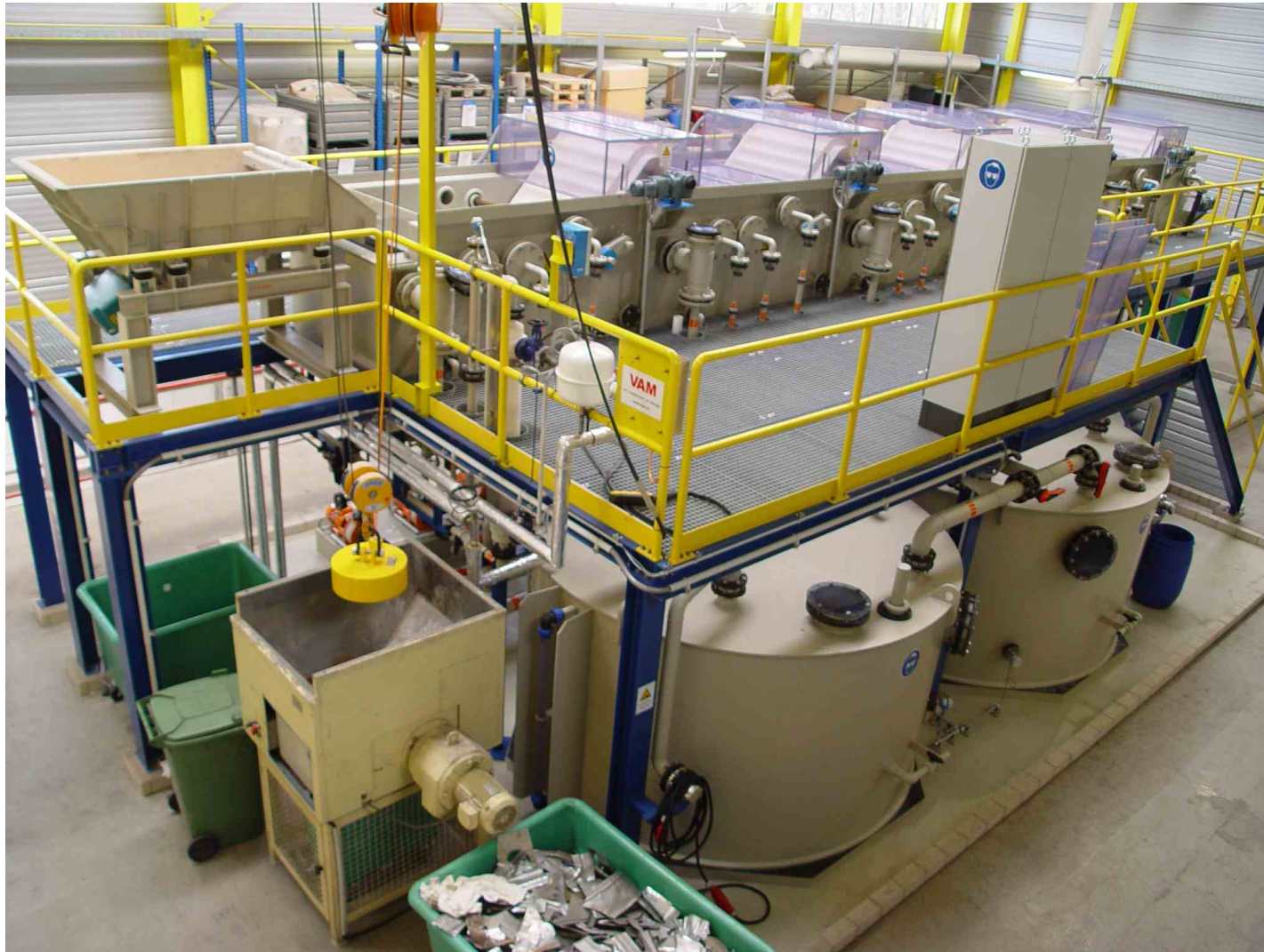
Entzinkungs- anlage in der CUTEC
